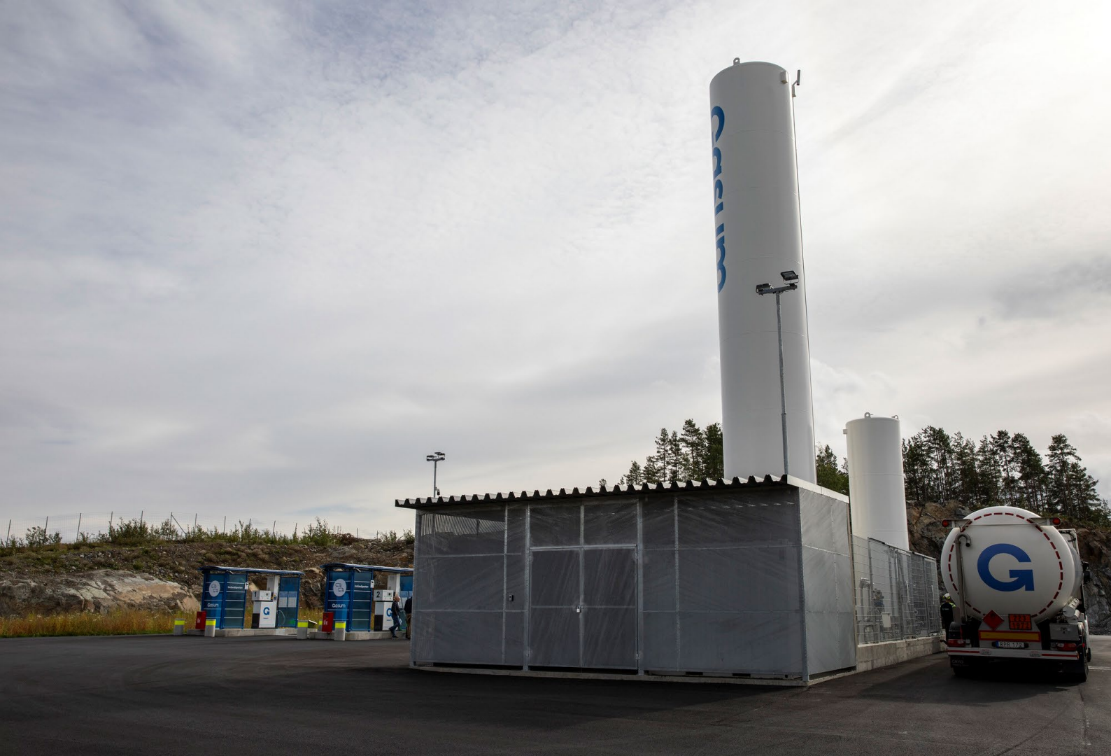
Biogassfyllestasjon på Innlandsporten i Stange kommune. Foto: Kristian Singh-Nergård/Østlandssamarbeidet
